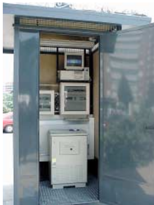
Estación de recarga para vehículos eléctricos. Valladolid
