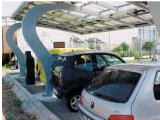
Marquesina fotovoltaica. Madrid
