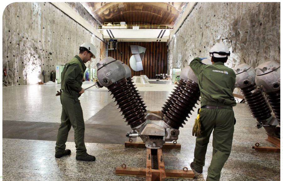
Trabajadores en la Central Hidráulica de Aldeadávila (Salamanca, España).
