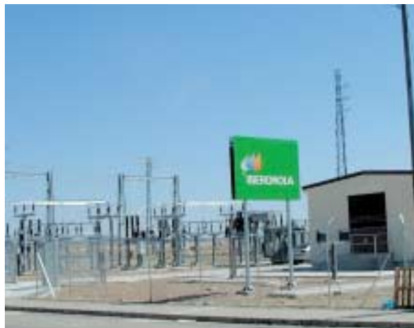
Subestación de San Vicente (Alicante)
