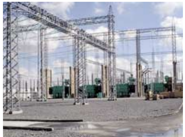
Subestación de Salamanca (Guanajuato, México)
