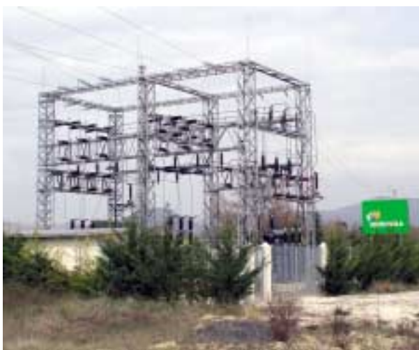
Subestación de Lorca (Navarra)
