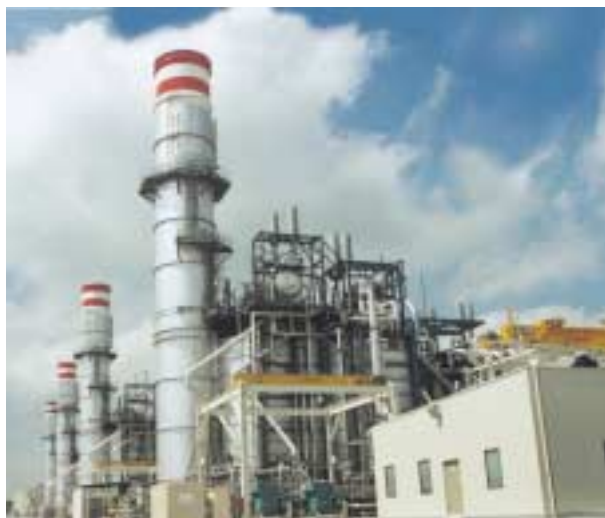
Central de ciclo combinado de Monterrey (México)
