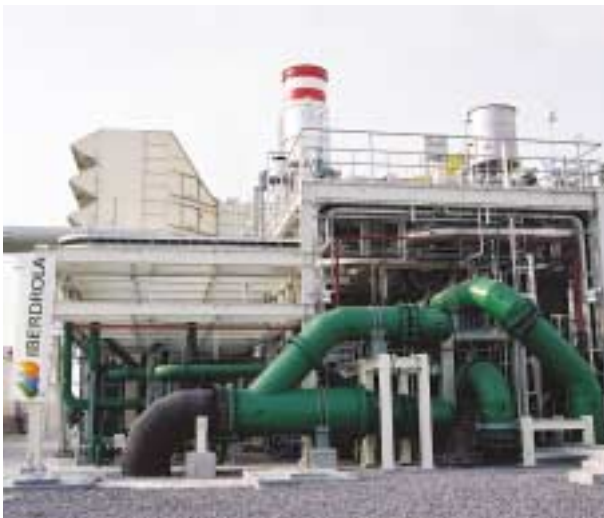
Central de ciclo combinado de Monterrey (México)
