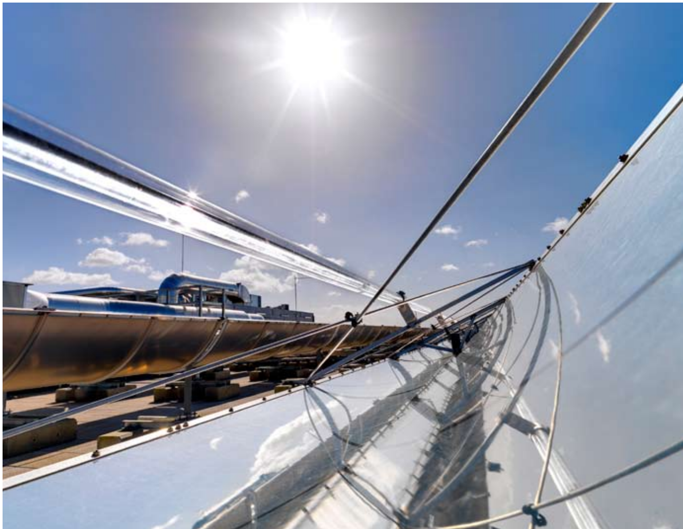
Colectores cilindro-parabólicos de una de las plantas solares de Abengoa
