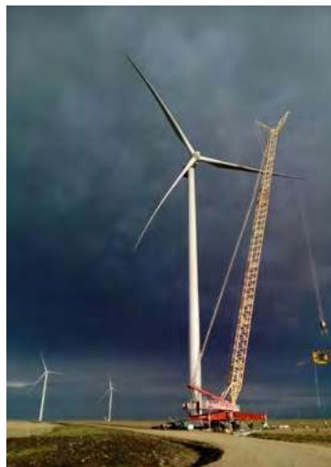
Abengoa finalizó en 2017 la construcción del parque eólico Campo Palomas.
