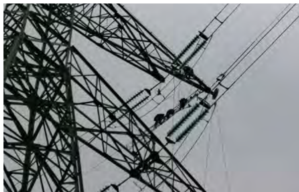
Detalle de línea de transmisión en Francia.
