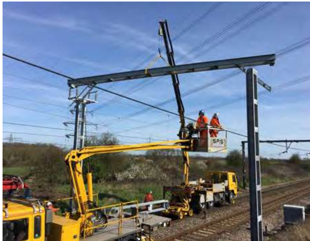
Abengoa lleva a cabo trabajos de catenaria en distintas líneas de Reino Unido.
