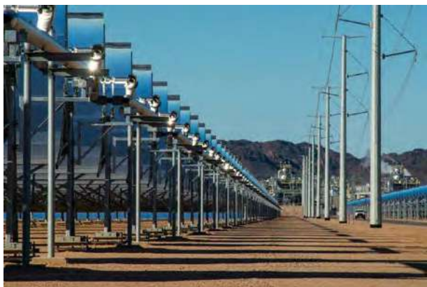
Vista de Solana, planta termosolar desarrollada por Abengoa en Arizona, propiedad de Atlantica Yield.
