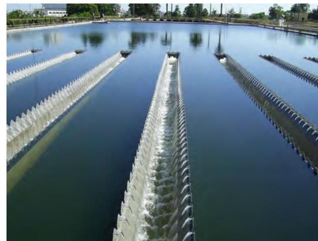
Detalle de planta potabilizadora realizada por Abengoa.
