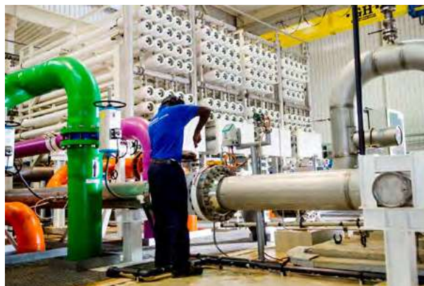
Labores de operación y mantenimiento en la planta desaladora de Accra, Ghana.
