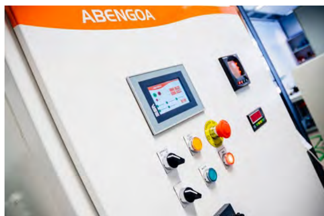
Convertidor de motores eléctricos de 100 MW.
