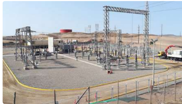
Uno de los hitos del pasado año en Perú fue la adjudicación de un proyecto de distribución eléctrica en el proyecto minero de Mina Justa.
