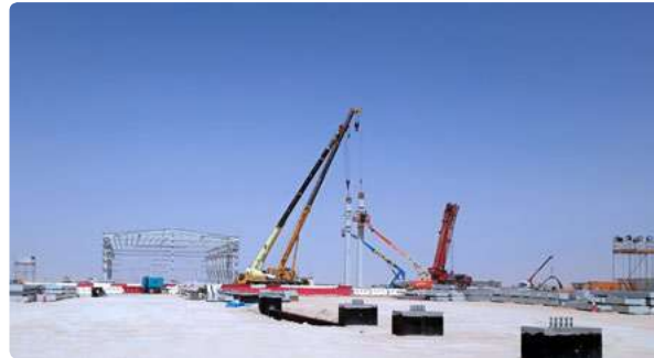
Abengoa trabaja en la construcción del complejo solar más grande del mundo, en Dubai.
