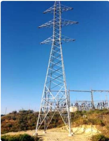
Torres para la línea de 220 kV en Cañuelo-Pinar del Rey.
