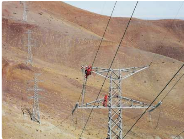
Repotenciación línea de transmisión Maitencillo Caserones.
