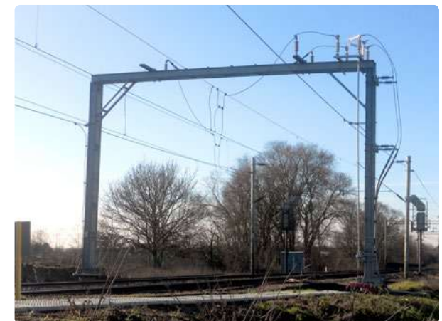
Pórtico ferroviario para modernización eléctrica ferroviaria en Inglaterra.
