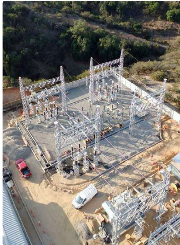
Imagen área de una de las subestaciones construidas para Chilquinta, en la región de Valparaíso.
