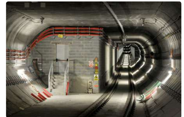
Instalaciones de alimentación del Metro de Barcelona.
