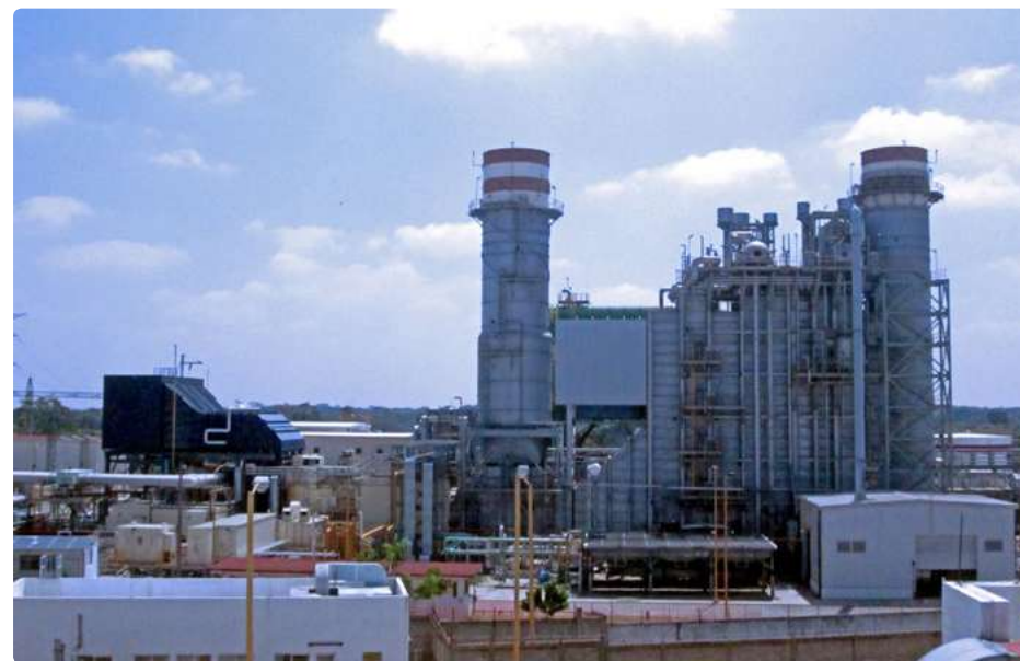
Planta de cogeneración eficiente A3T.
