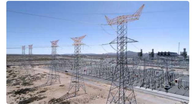
Trabajos realizados en la línea de transmisión asociada al ciclo combinado Norte III.
