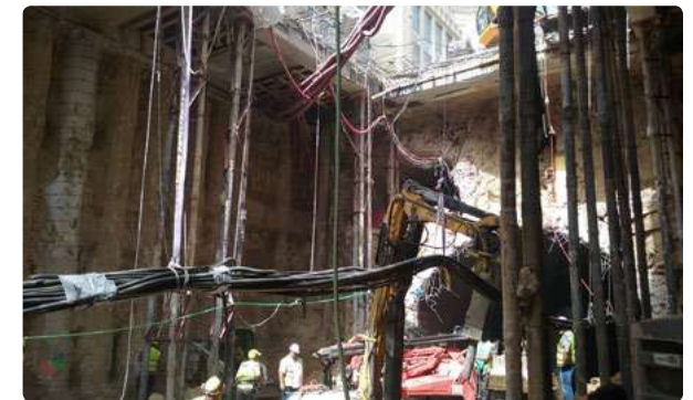
Remodelación de los sistemas de comunicaciones y control de la estación de metro Sevilla (Madrid).
