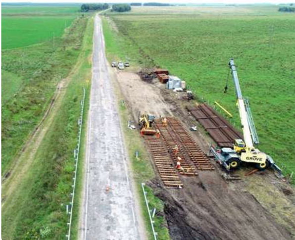
Abengoa se está encargando de la rehabilitación de 327 km de vías férreas.
