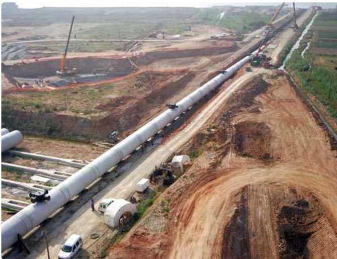
Abengoa cuenta con un portfolio de más de 1.100 km de grandes conducciones de agua.
