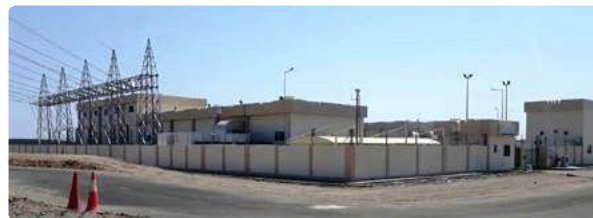
Subestación GIS de 132/33 kV en Omán.
