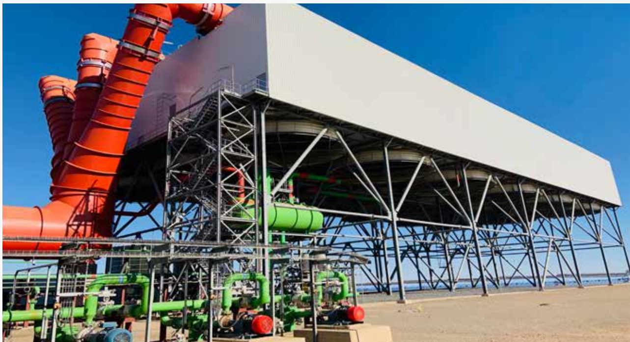
► Vista general del gran aerocondensador de Kaxu Solar One.
