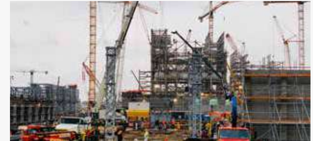
► Trabajos en las torres de transmisión en las inmediaciones de la planta de generación de biomasa de Arauco.
