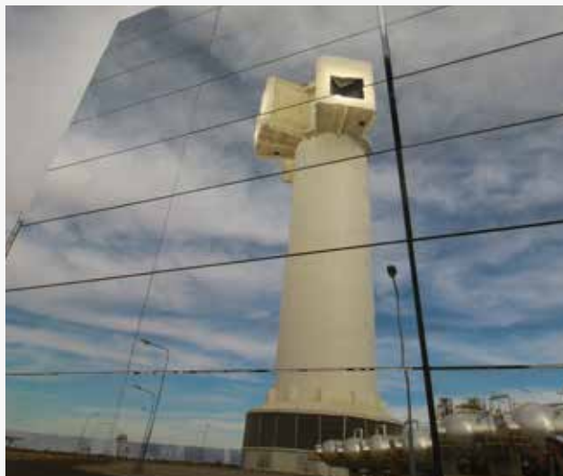
► La imponente torre de Khi Solar One se refleja en uno de los heliostatos de la central.
