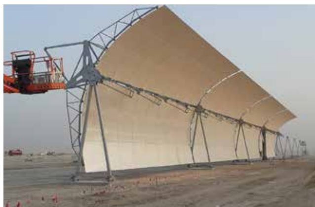
► Uno de los colectores cilíndricos del campo solar de la fase IV del Al Maktoum Solar Park.
