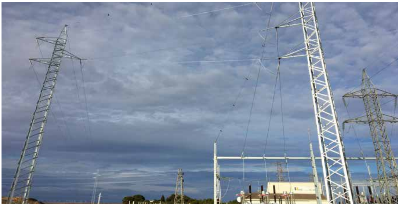
► Torre de diseño propio para la línea San Agustín (Zaragoza) de 132 kV fabricada por Eucomsa.
