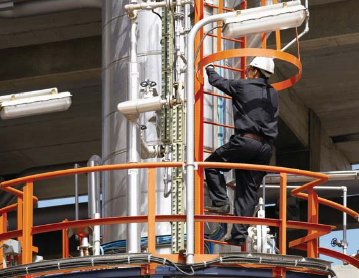
Técnico en la refinería "La Rábida"
