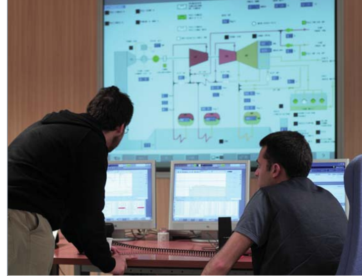
Sala de control de central eléctrica de ciclo combinado
