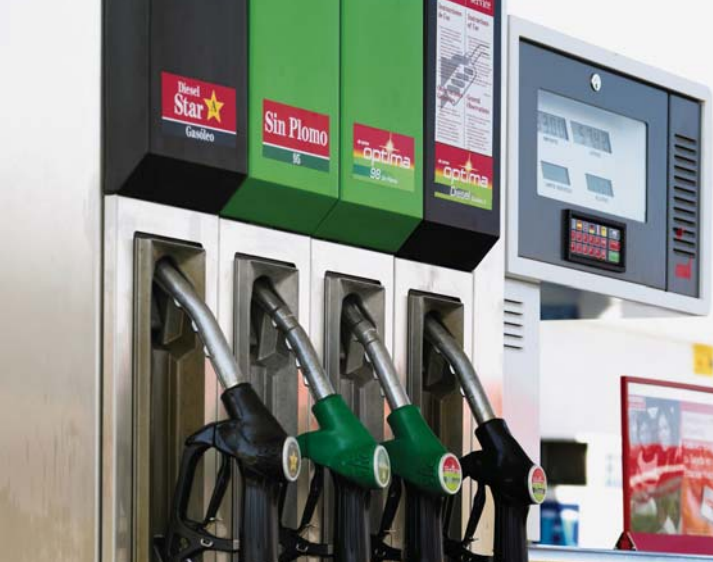
Surtidor estación de servicio
