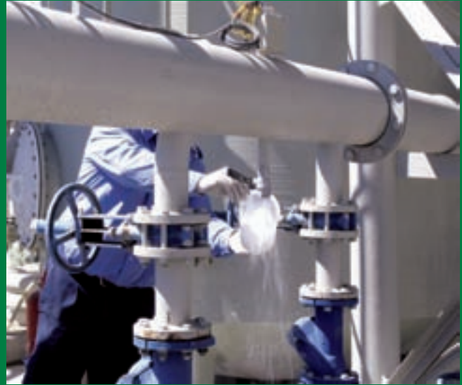
Estación depuradora de aguas residuales. Consentino. Almería
