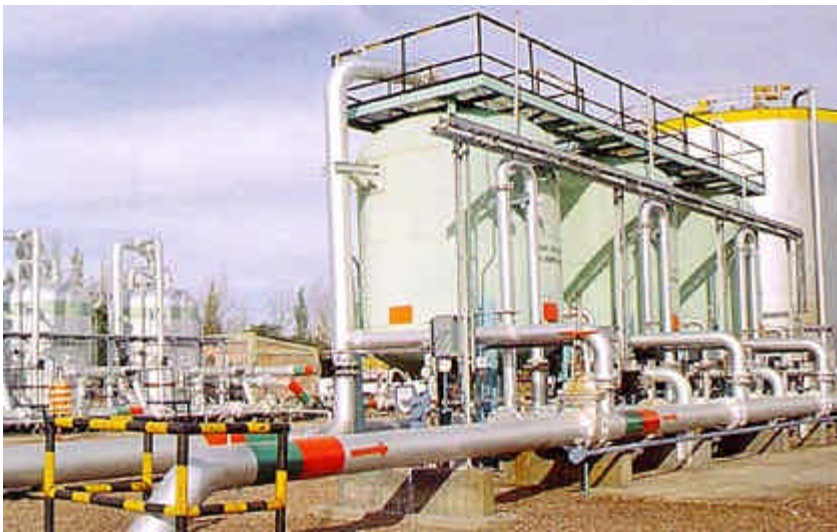
Instalaciones para la gestión del agua de producción en el yacimiento La Ventana (Argentina).
