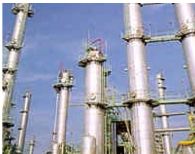
Instalaciones de Repsol Química en Tarragona.
