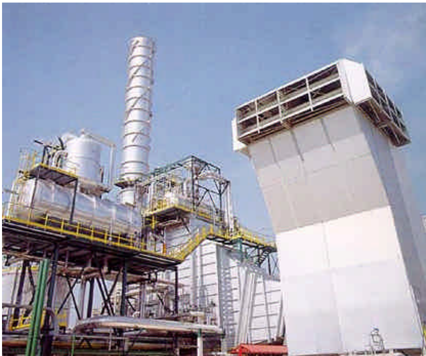
Nueva unidad de cogeneración del complejo químico de Tarragona.
