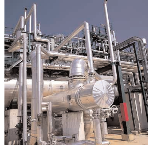
▲ Planta de cogeneración de la refinería de Tarragona.
