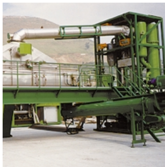
Las refinerías de Bilbao y Tarragona disponen de plantas de desorción térmica para el tratamiento de lodos.
