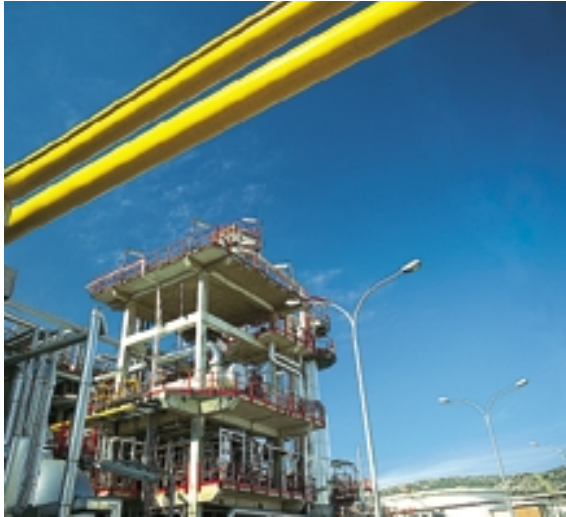
Planta de hidrógeno de la refinería de Puertollano.
