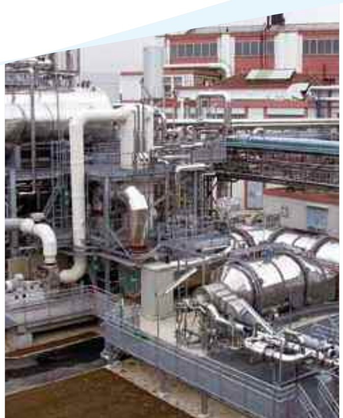
Anlage zur Aufbereitung flüchtiger organischer Substanzen (VOC) durch thermische Oxidation im Produktionszentrum Vity
