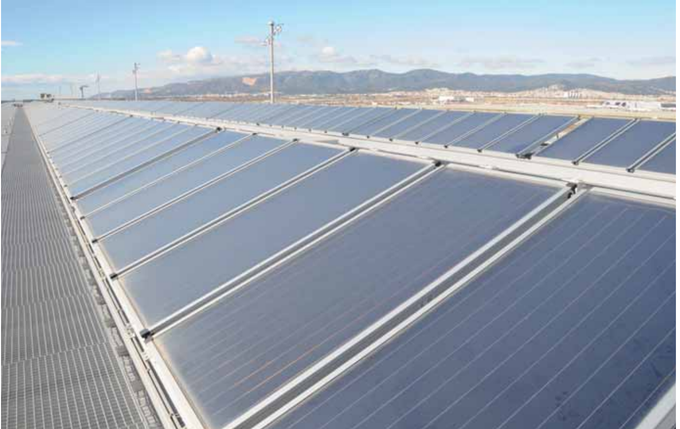
Paneles de energía solar en el Aeropuerto de Barcelona-El Prat.
