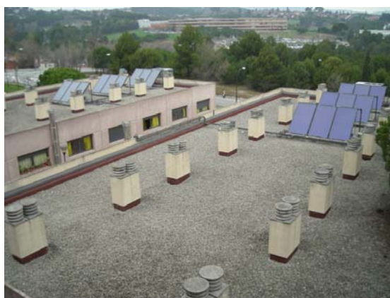
Imatge 15. Col·lectors solars tèrmics a la Vila Universitària. Mòduls L i M.
