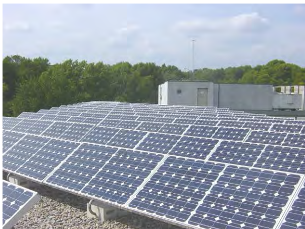
Imatge 9. Instal·lació solar fotovoltaica de la plaça Cívica.
