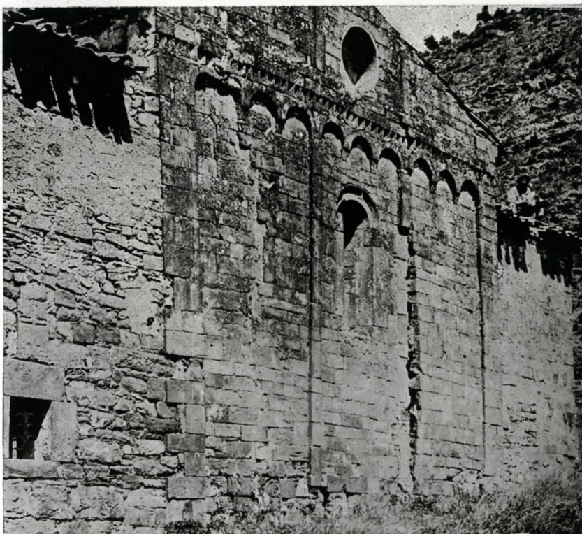
Conjunt de l'absis romànic de Castellfollit i detall d'una grossa esquerda i desplom del parament, abans de la restauració
