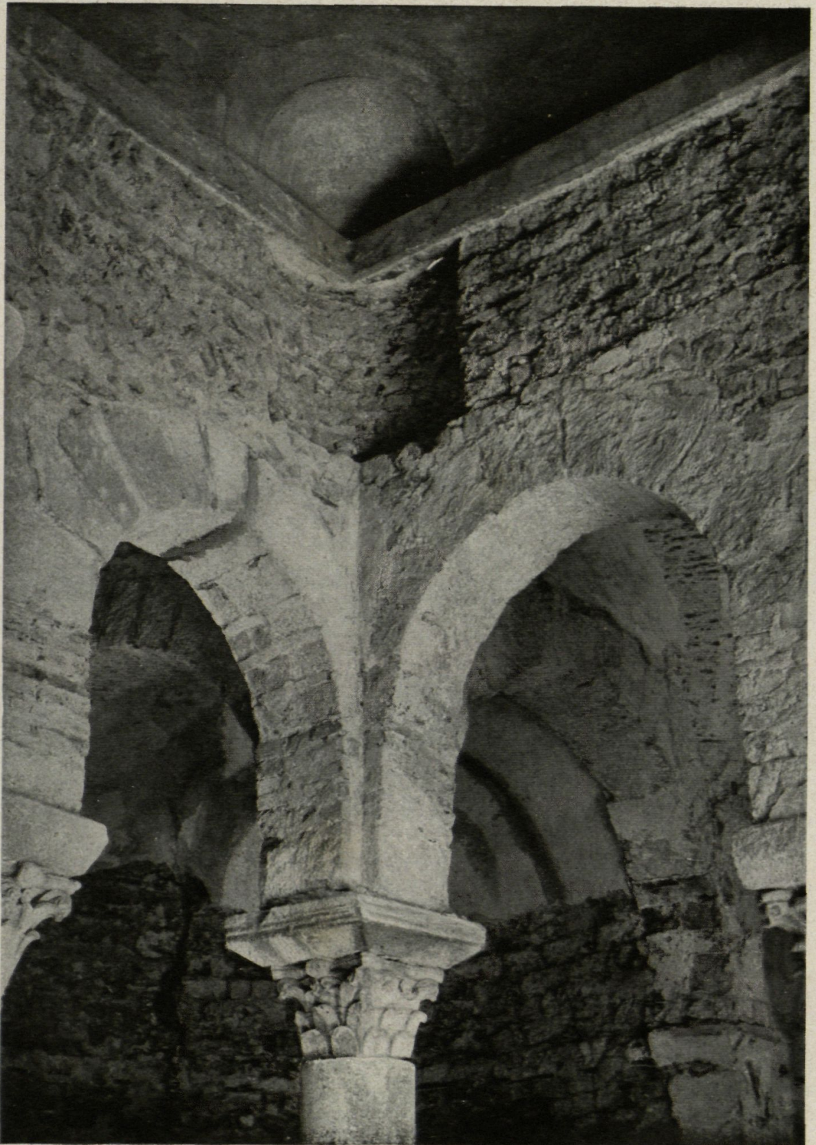
Fig. 44. — Seu d'Egara : Fornàcul del baptisteri de Sant Miquel abans de treure la faixa de maons moderna
