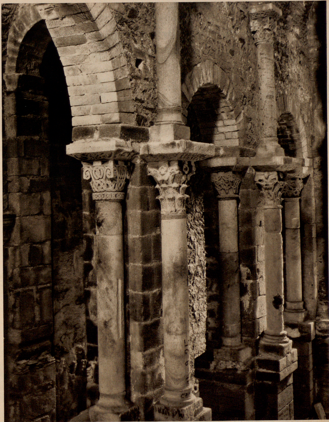
Fig. 10.—DETALLE DE LAS ARQUERÍAS LATERALES EN LA NAVE CENTRAL DE LA IGLESIA DEL MONASTERIO DE SAN PEDRO DE RODA (GERONA).
