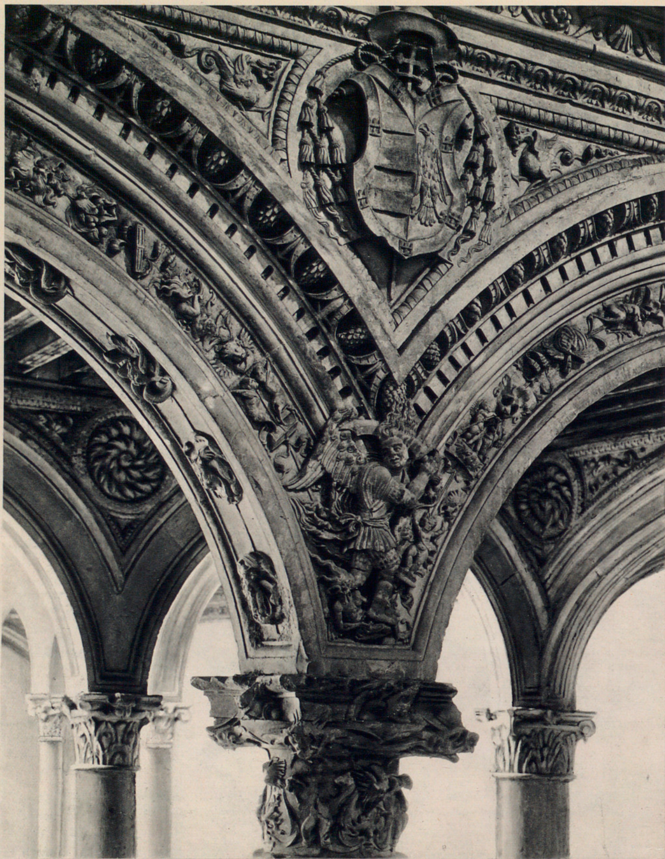
Fig. 128. — PORMENOR DE LA ARQUERÍA DE ARRANQUE DE LA ESCALERA DEL PALACIO ARZOBISPAL DE ALCALÁ DE HENARES.
