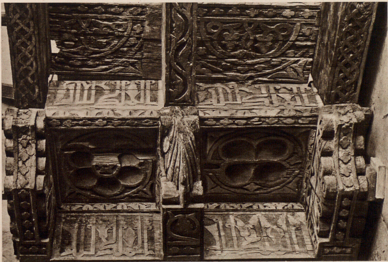
Fig. 400.— DETALLE DEL TECHO QUE CUBRIÓ LA NAVE MAYOR DE LA IGLESIA DE SAN MILLÁN, EN SEGOVIA.
