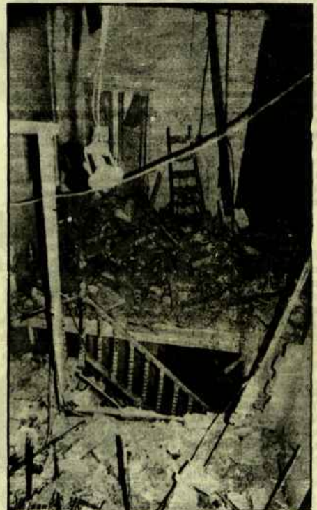
Estado en que quedó nuestra redacción en Harrisburg
