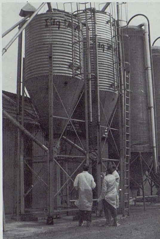
Los silos metálicos conectados a una pesadora electrónica para conocer permanentemente las existencias de pienso y el consumo.
