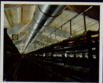
Refrigeración y calefacción por conducto de chapa. Codornices, pollitas, etc.
