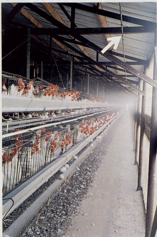
Aspecto de un pasillo exterior en el momento de ponerse en marcha la nebulización. La flecha señala la situación de la tubería a la que van conectadas las boquillas.
