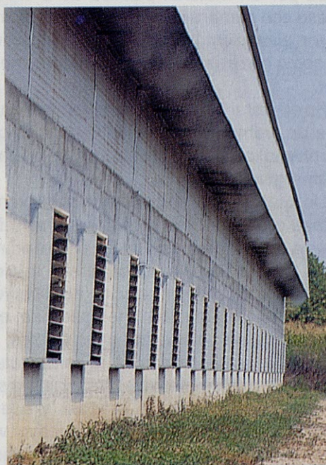
Ventilación transversal y túnel de humidificación en una nave elevada.
