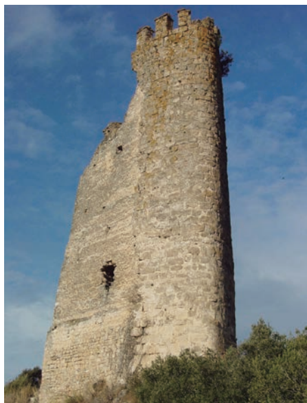
Figura 7. Vista general de la torre de Santa Perpètua donde se ve la proa o vértice este correspondiente al extradosado o forro de la torre.
