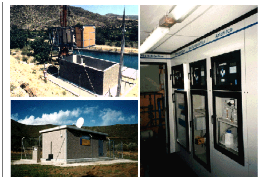
Figura IV.27 Fotografies en detall d'una EAA (Estació Automàtica d'Alerta, model Castor). Procés de muntatge (fotografia superior esquerra), perspectiva una vegada instal·lada (fotografia inferior esquerra) i vista de l'interior, amb els equips AQUAMONIA ® , AQUATEST ® i AQUAMOSTRA ® en sèrie (fotografia dreta).
