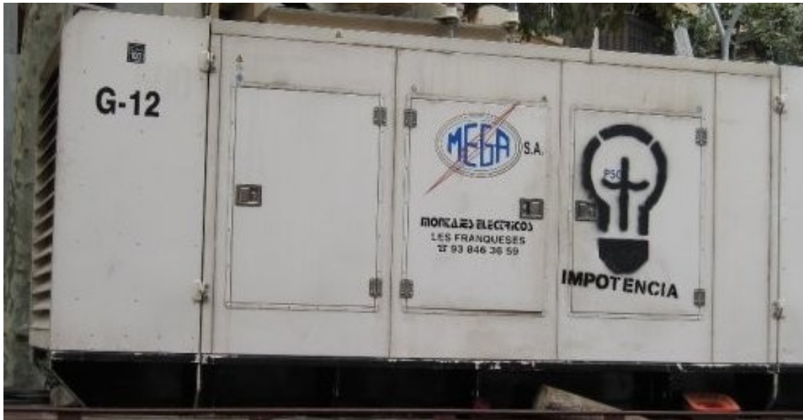
[Generador eléctrico, 2007. fotografía del autor.]
