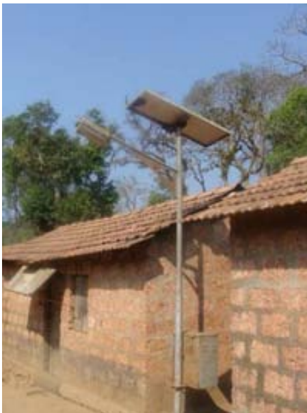
Figura anexo 2.12 Infraestructura de electricidad solar (sin funcionamiento) en Kodagu (Karnataka, India).
