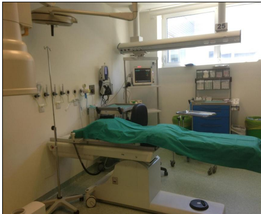
Imagen 7: Sala de tratamientos (II). Unidad de Dolor
