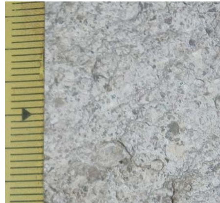
Figura 9.8: Mostra fotogràfica del morter de l' opus caementicium corresponent, molt probablement, al del reblliment de la muralla en proximitat de la torre V/9. Superfície a la vista. (foto: A. Ravotto).
