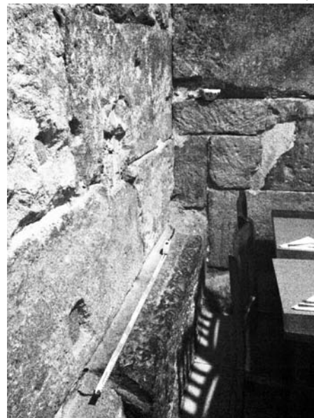
Figura 9.27: Cotes inferiors del costat NO de la torre XI/8 (torre 53 de la numeració tradicional) i llenç entre aquesta i la torre XI/9 (torre 54; foto: A. Ravotto).
