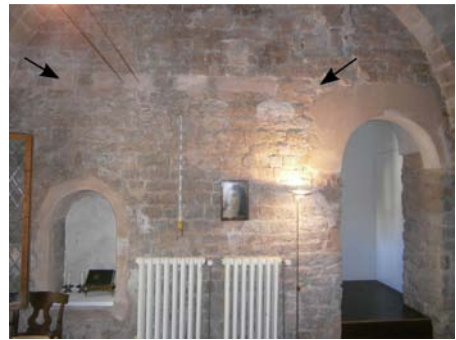
Figura 9.58: Interior de la torre XV/4 (torre 74), façana NE. Amb les fletxes s'indica la filada de parament que sostenia el paviment del segon pis (foto: A. Ravotto).
