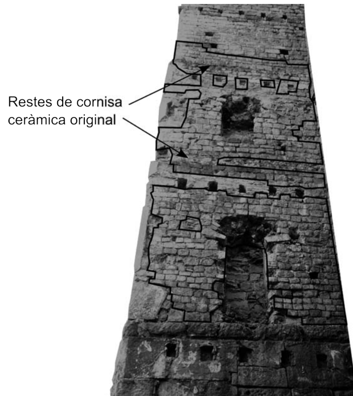
Figura 9.53: Costat N de la torre V/4 (= torre 27). S'evidencien, de manera aproximada, les parts originals respecte a les integracions posteriors. El nivell de detall no és gaire acurat, i dins del pany romà existeixen punts refets, sobretot per tal d'adossar-hi habitacions civils d'època moderna (A. Ravotto).
