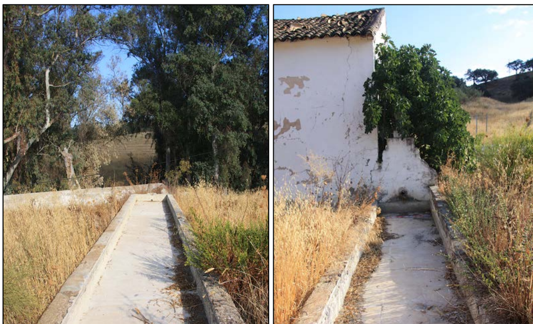
Imatges 6 i 7- El tram final de la canalització de la Venta del Granadal
