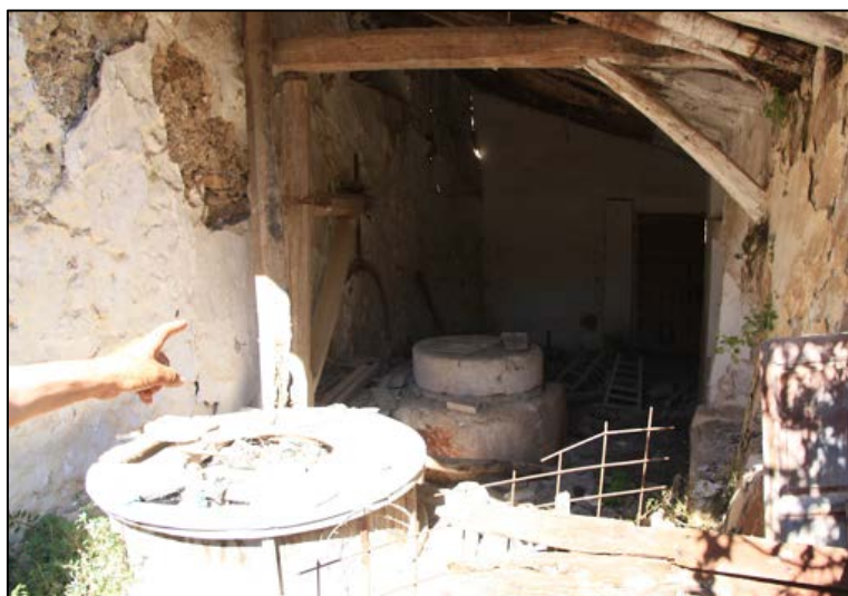
Imatge 16- Sala de màquines del Molino de las Camachuelas
