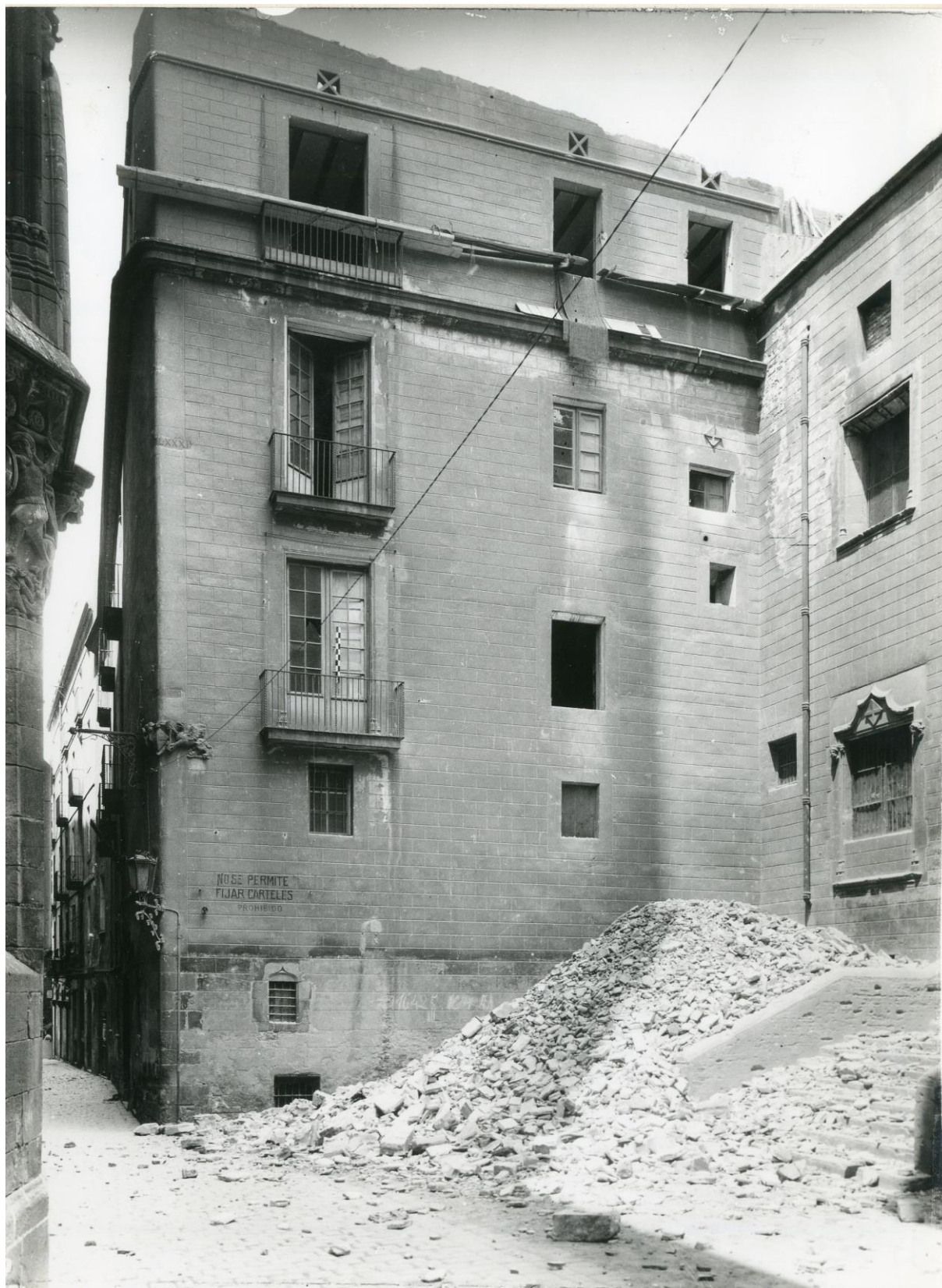
Figura 31. Façana del Museu Frederic Marès. Obres de la Plaça de Sant Iu de Barcelona, maig de 1943. nr. 1053. Museu Frederic Marès. ©Foto: Francisco Ribera.
