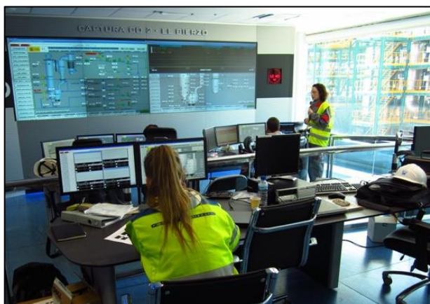
Figura 3.2.1.1. Sala de control
