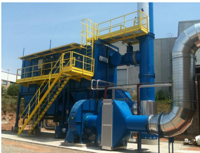
Figura 6-1. Equip d'oxidació tèrmica regenerativa.
