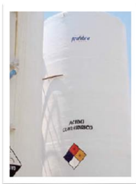
Figura 2.3. Tanque de almacenamiento de ácido clorhídrico
