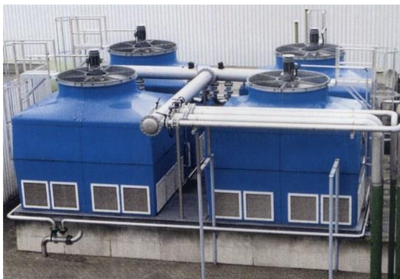
Figura 1-23 Torre de refrigeración marca EWC.
