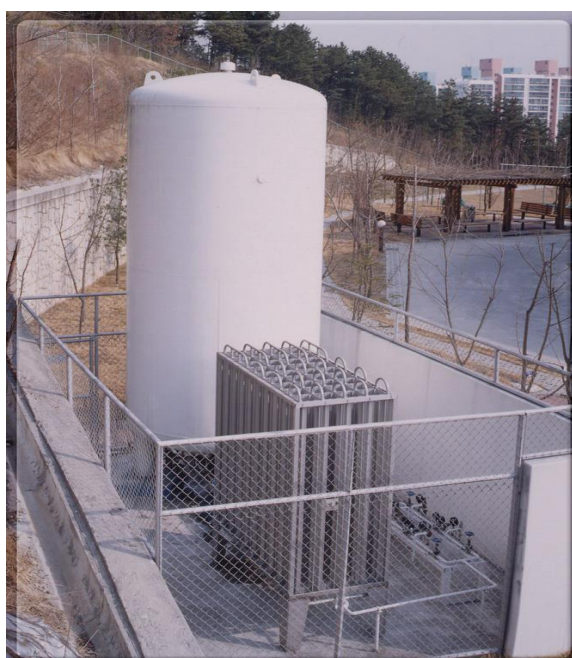
Figura 2: Ejemplo tanque criogénico
