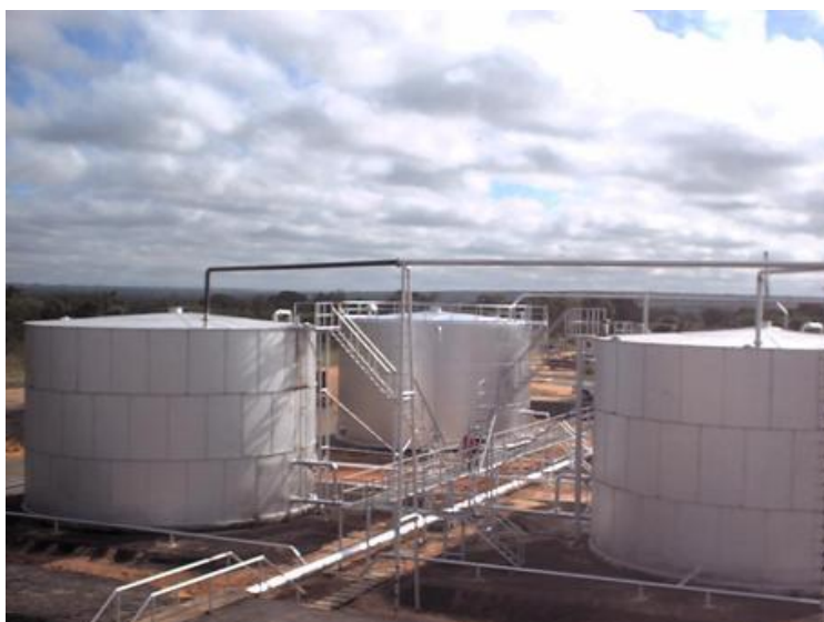
Figura1: Ejemplo de tanques a presión atmosférica
