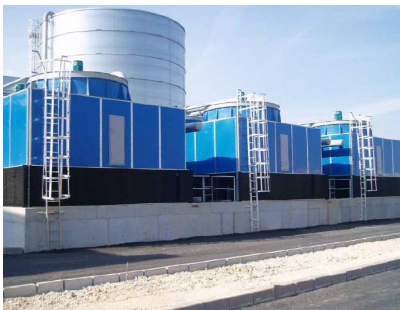
Figura 1-19 Torres de refrigeració de la marca EWK (Model EWB)
