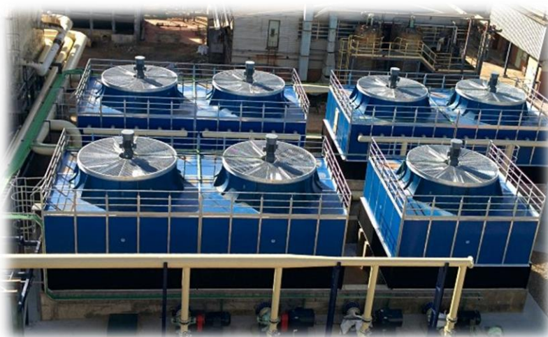
Figura 1. 9. Torres de refrigeració
