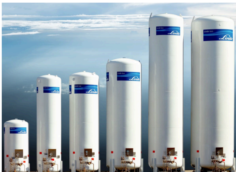
Figura 11.1.5. Tanque criogénico para el almacenamiento de CO
