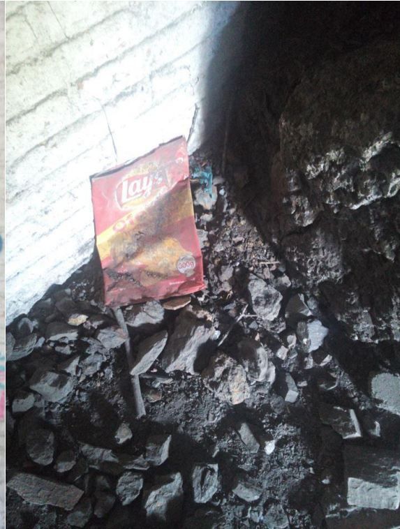
Figura 22. Exemple de brossa en una galeria. Font: Elaboració pròpia
