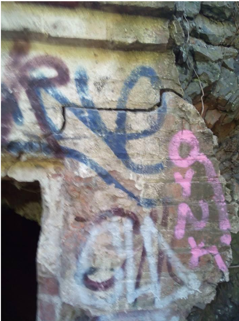
Figura 41. Fissura de la cornisa a l'entrada de la galeria 4. Font: Elaboració pròpia.
