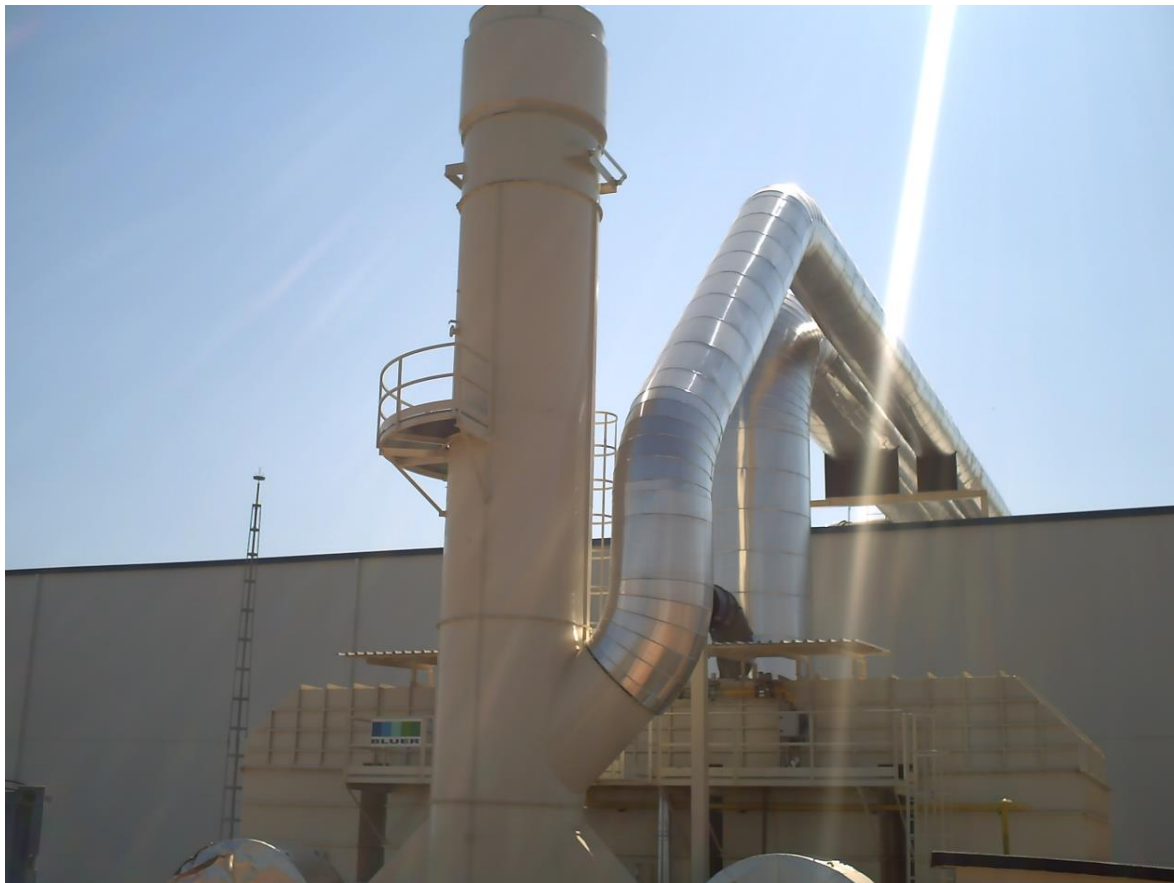
Figura 6.3.3.1: Instal·lació d'oxidació tèrmica regenerativa
