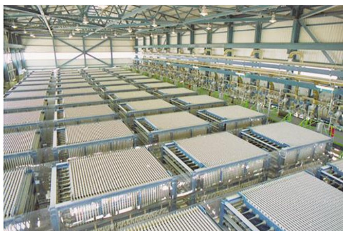
Figura 12- 2: Sala de celdas electrolíticas de membrana para producir cloro gas
