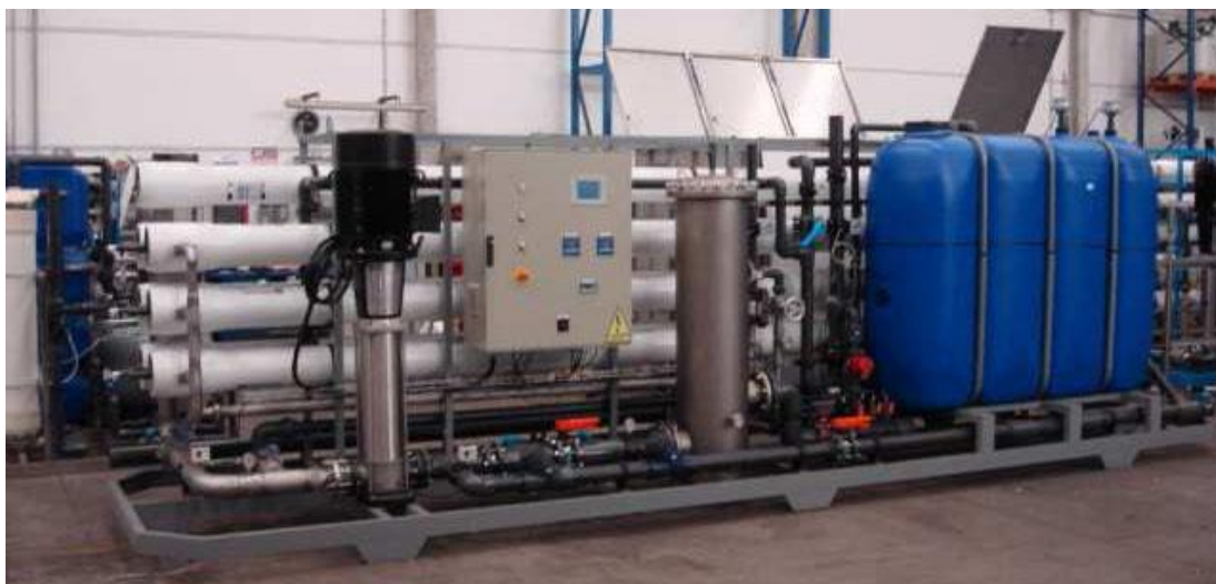
Figura 12- 3: Aspecto de un equipo de osmosis inversa industrial
