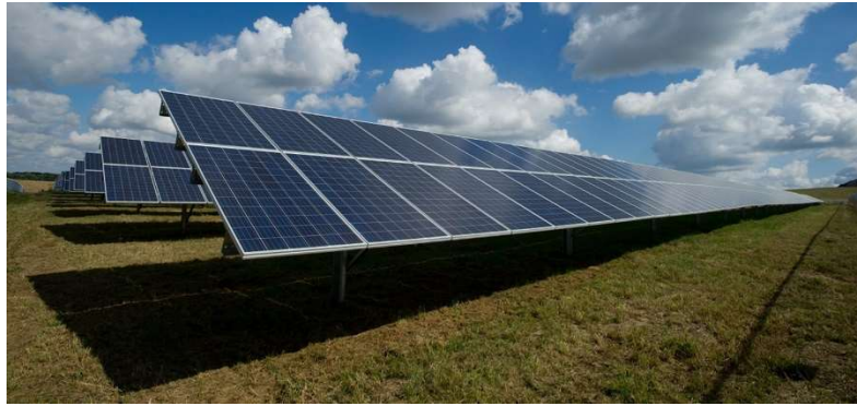
Figura 1. Placas solares para generación de energía renovable.
