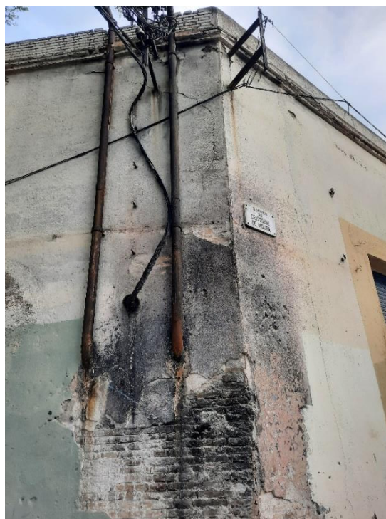
Figura 34: Deteriorament, C/ Cristòbal de Moure
