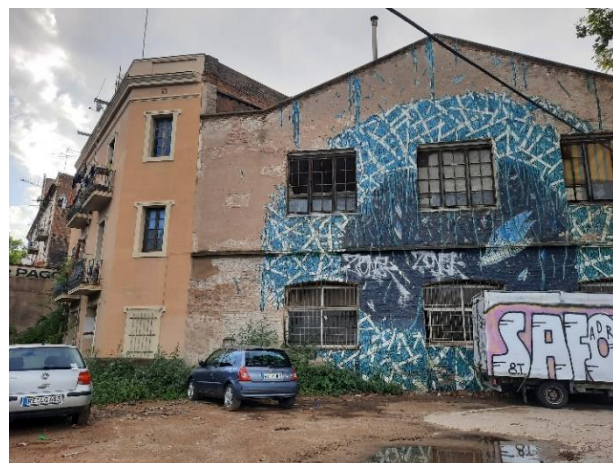
Figura 33: Edifici abandonat, C/ Selva de Mar
