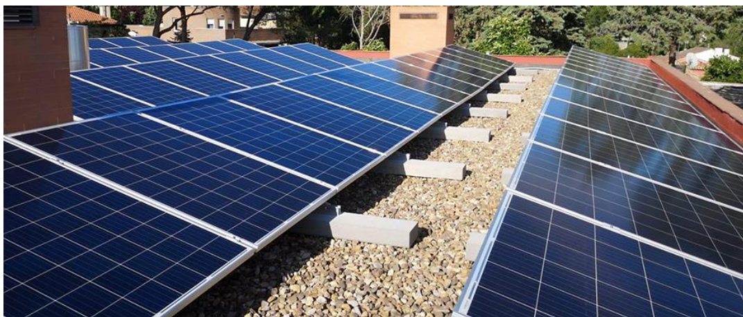
Figura 9: Plaques solars al sostre d'una edificació
