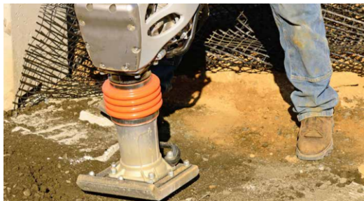
Figura 12. Maquinaria que pot provocar
