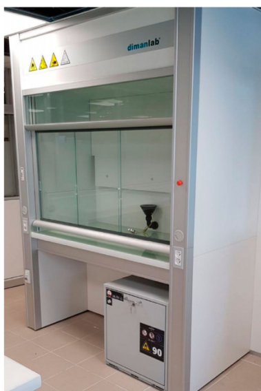
Figura 17: Campana ventilació laboratoris.
